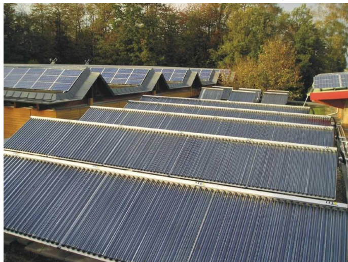
Bild 4: Heißstart-Testanlage (2007): 2 m 3 Pufferspeicher + 196 m 2 Kollektorfläche
